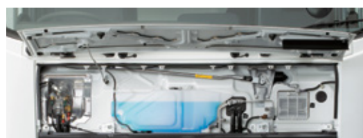
前置檢查裝置，日常檢查簡單便利。
